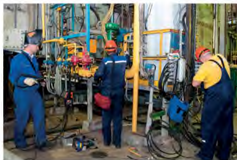
Специалисты Honeywell производят замену АСУТП на ОВК-2
